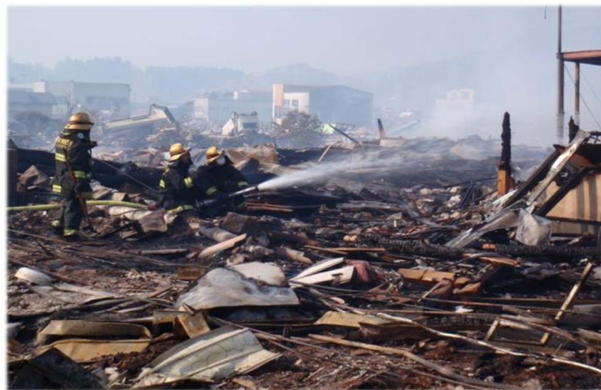
消防隊による消火活動①
