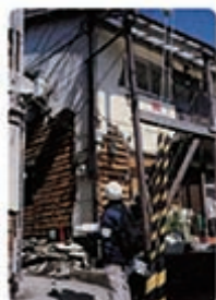
出典：全国被災建築物応急危険度判定協議会
