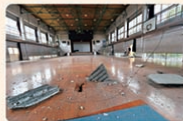
熊本地震の際の熊本県熊本市の体育館 写真提供：毎日新聞社
